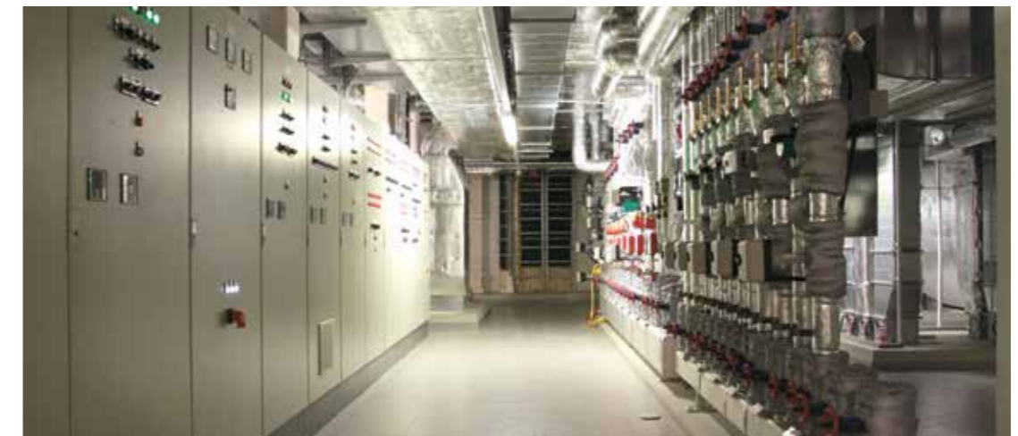
Technikzentrale des zentralen Ops
